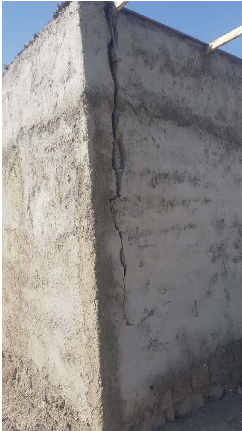
تصویر ۱۸ ترک ایجاد شده در دیوار بلوک سیمانی ساختمان بدون کلاف روستای ذرتو
