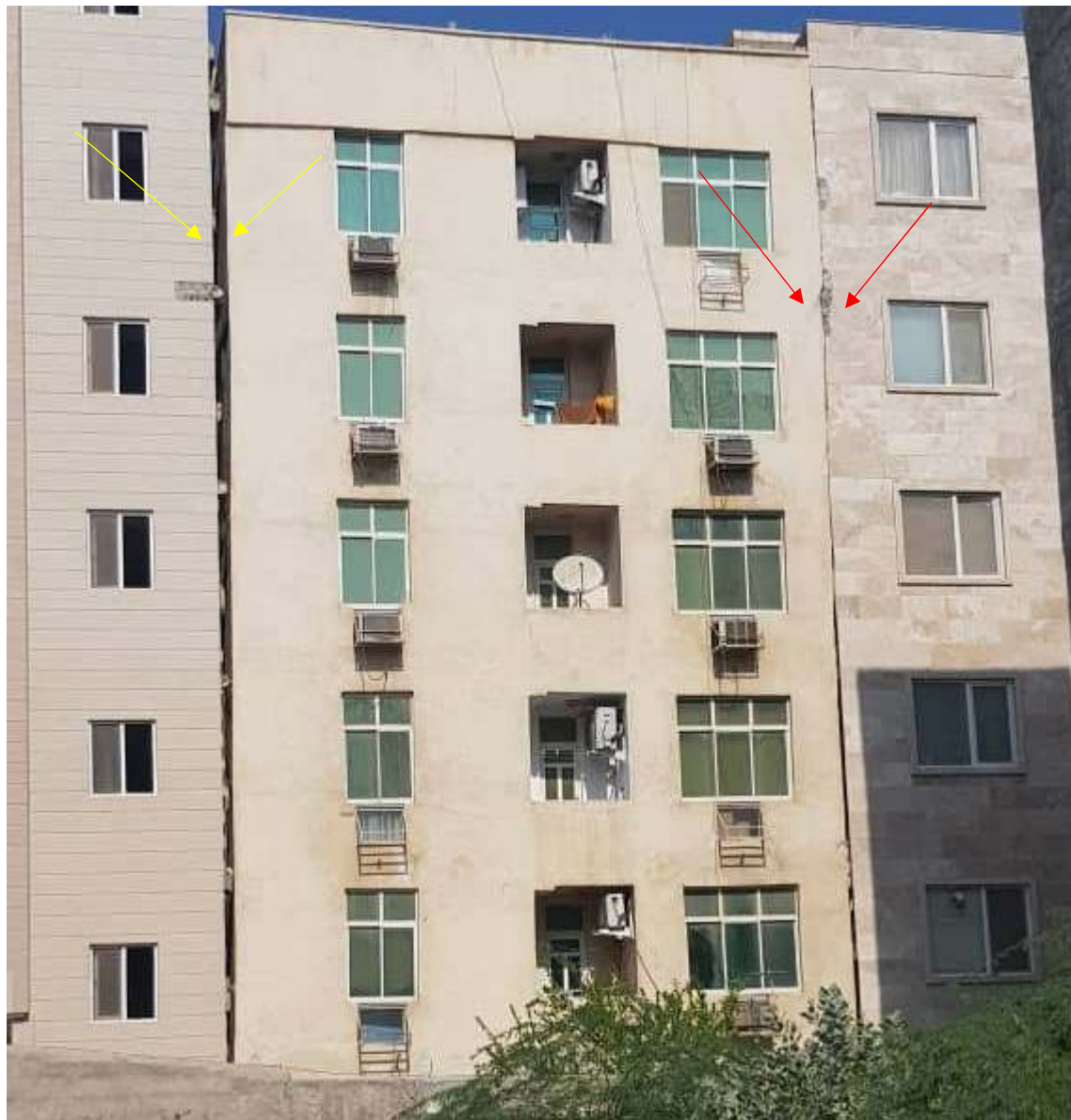
تصویر ۱۳ نشست و چرخش ساختمان به راست و جلو در الهیه جنوبی بندرعباس
