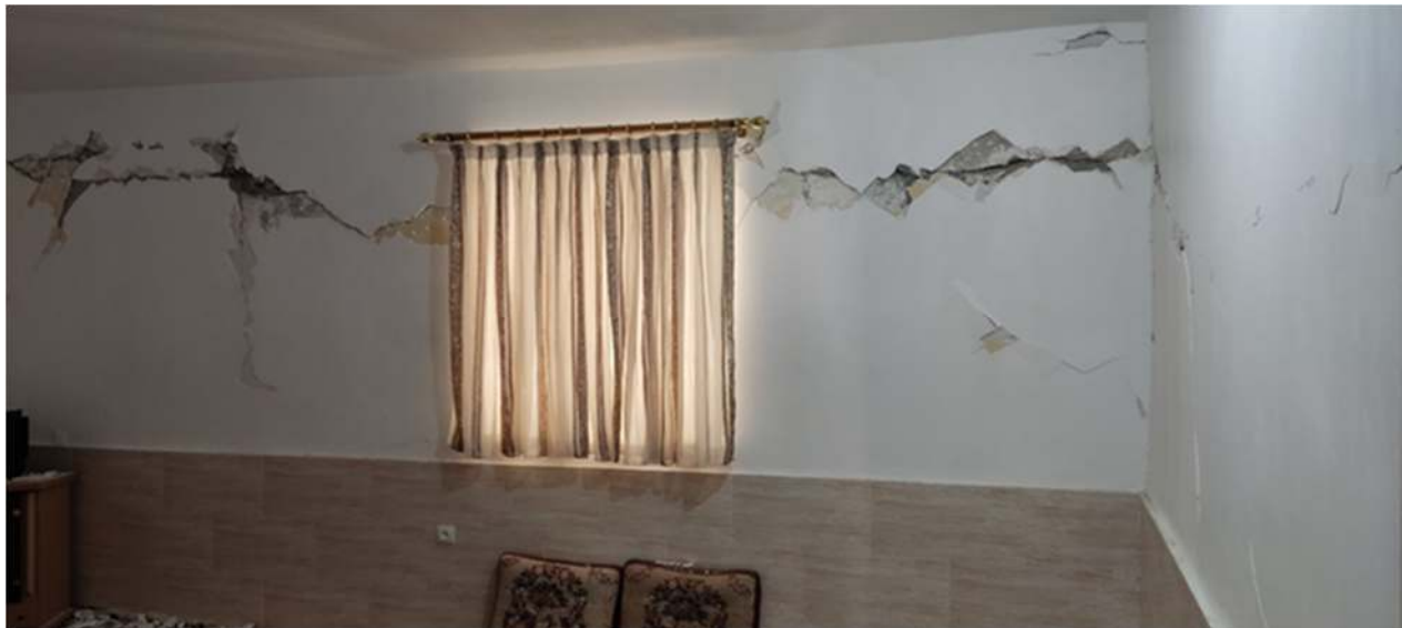
تصویر ۲۴ ایجاد ترک های افقی در محل اجرای لوله خرطومی برق
