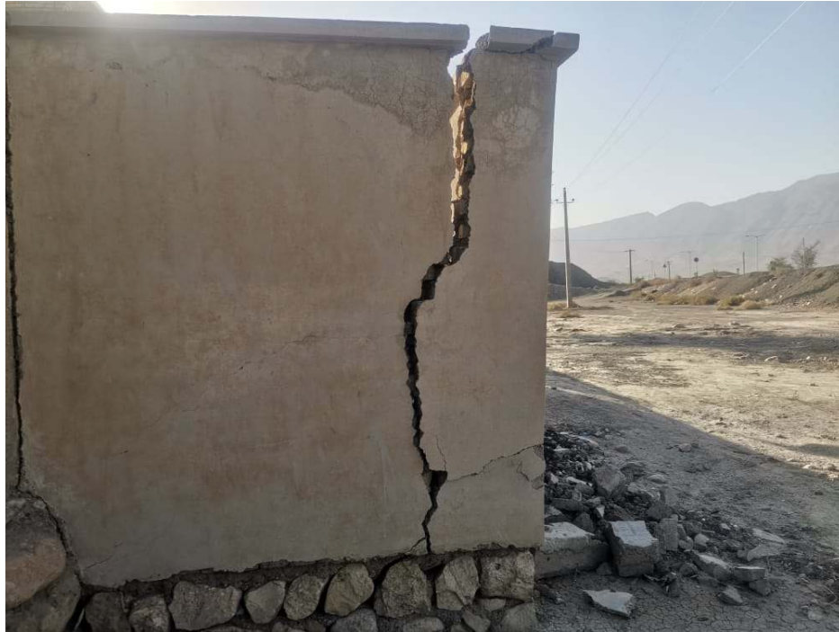
تصویر ۷۲ ترک قائم دیوار آجری در روستای قطب آباد
