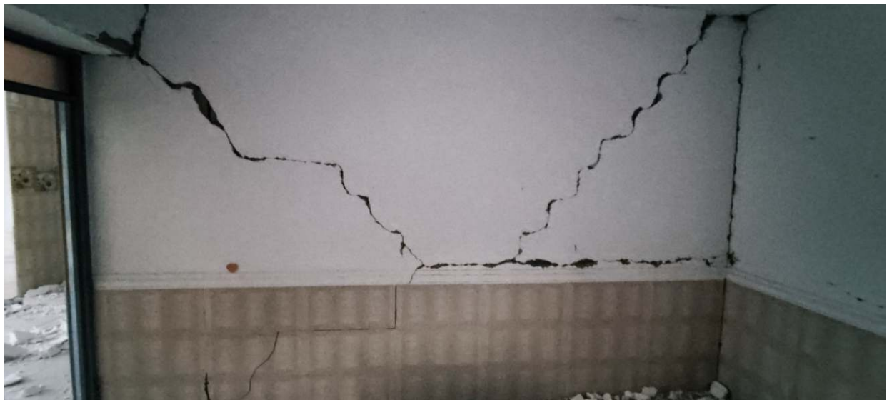
تصویر ۱۴ ایجاد ترک‌های قطری در دیوار ساختمان بنایی فاقد کلاف در گیشان
