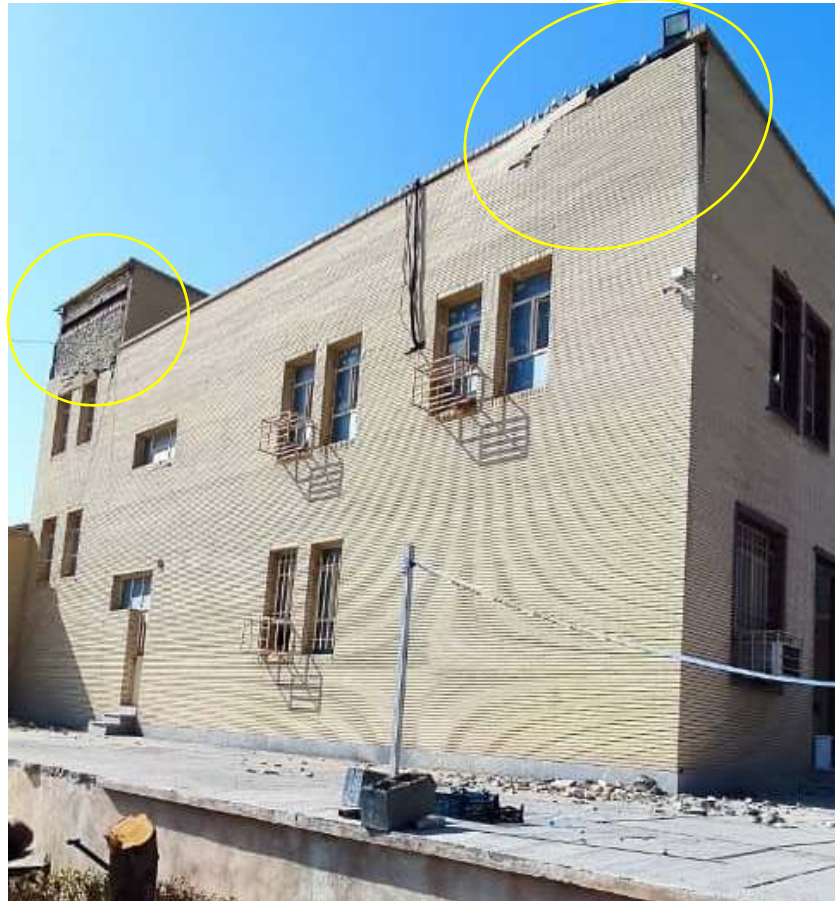
تصویر ۶۵ ریزش پلاک آجری خرپشته و عدم اتصال مناسب نما به ساختمان در شهرداری فین
