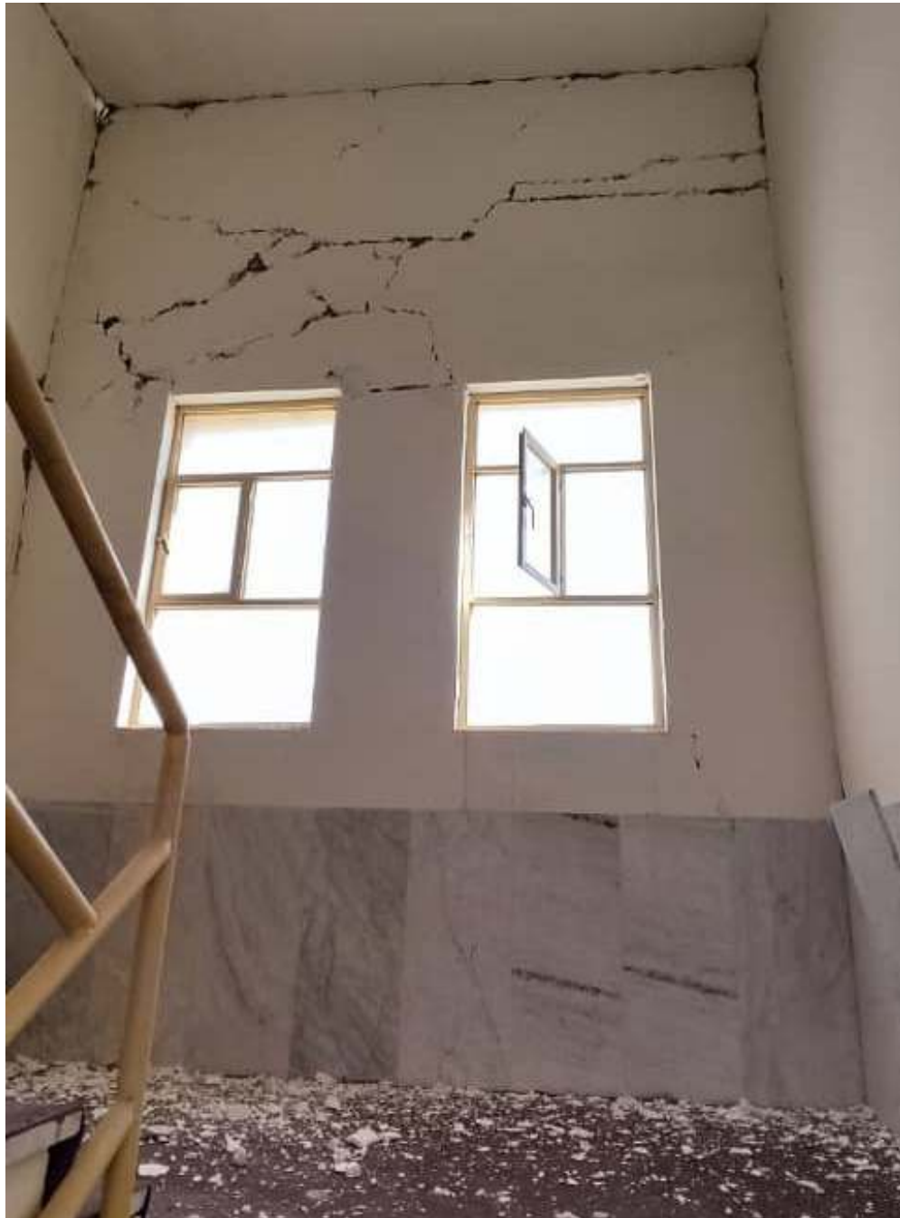
تصویر ۷۶ ترک‌های افقی دیوار و ریزش خرپشته در محل شهرداری فین
