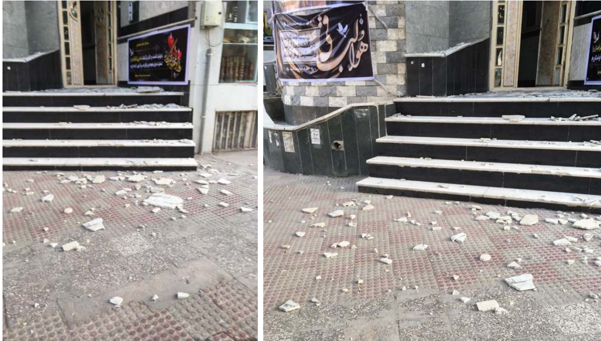
تصویر ۵۹ ریزش نمای سنگ مجتمع ساختمانی در شهر بندرعباس
