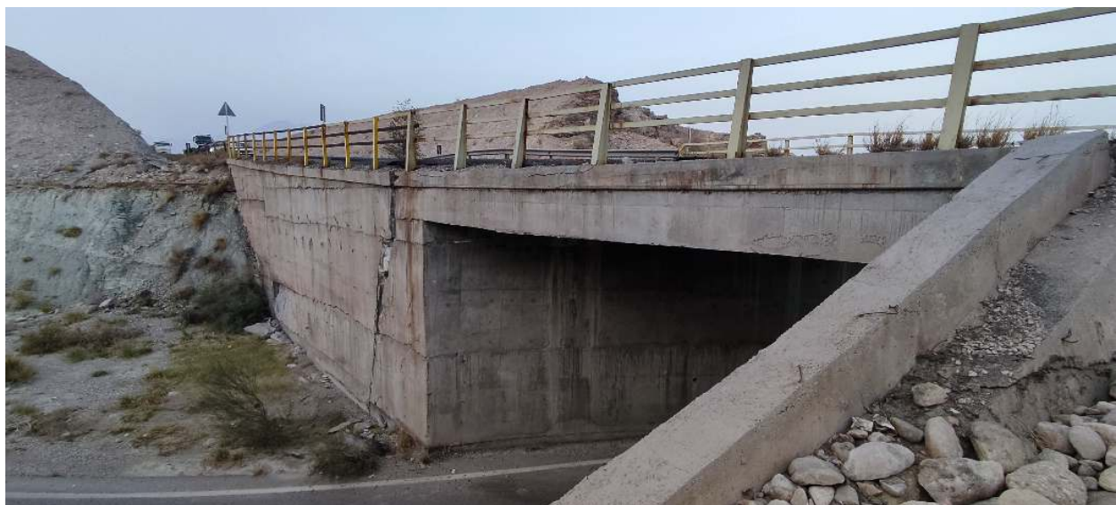
تصویر ۹۷ جابجایی و ایجاد ترک در دیواره پل نرسیده به روستای گیشان غربی
