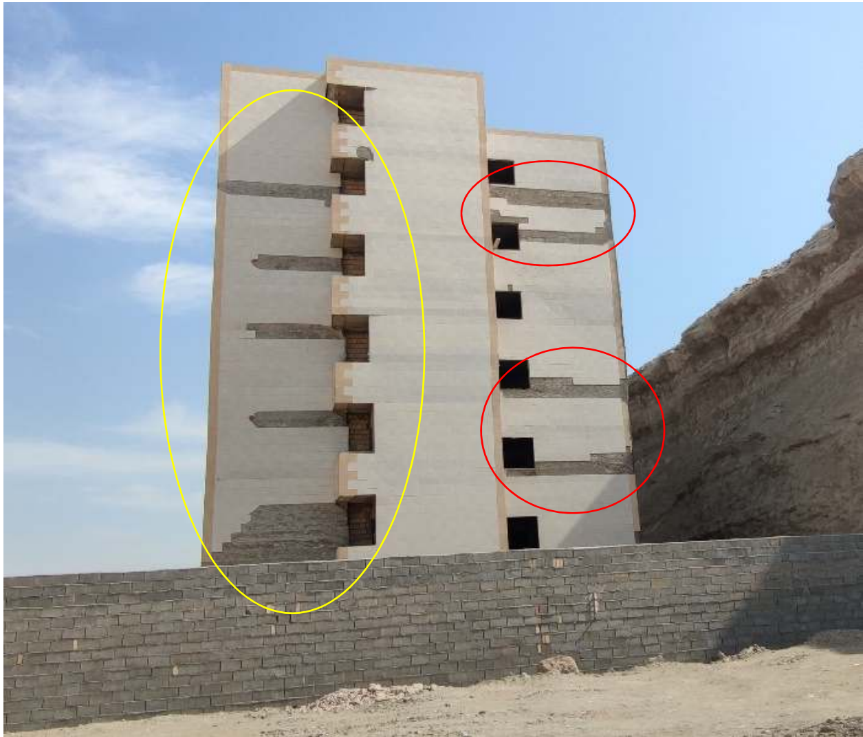
تصویر ۶۳ ریزش نما در ساختمان اسکلت بتنی قبل از بهره‌برداری در بندرعباس
