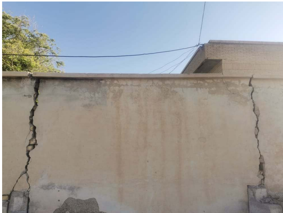
تصویر ۷۳ ترک قائم دیوار آجری در روستای قطب آباد
