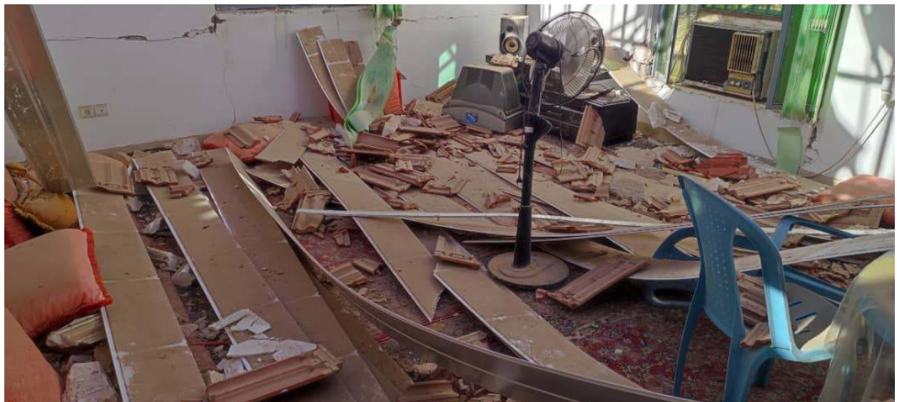
تصویر ۳۷ ریزش سقف سفالی و به طبع آن سقف کاذب در روستای ذرتو
