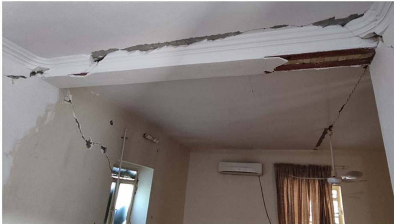
تصویر ۲۲ ترک خوردگی قطری در مجاور بازشوها و ترک خوردگی محل اتصال تیر حمال و سقف تیرچه بلوک
