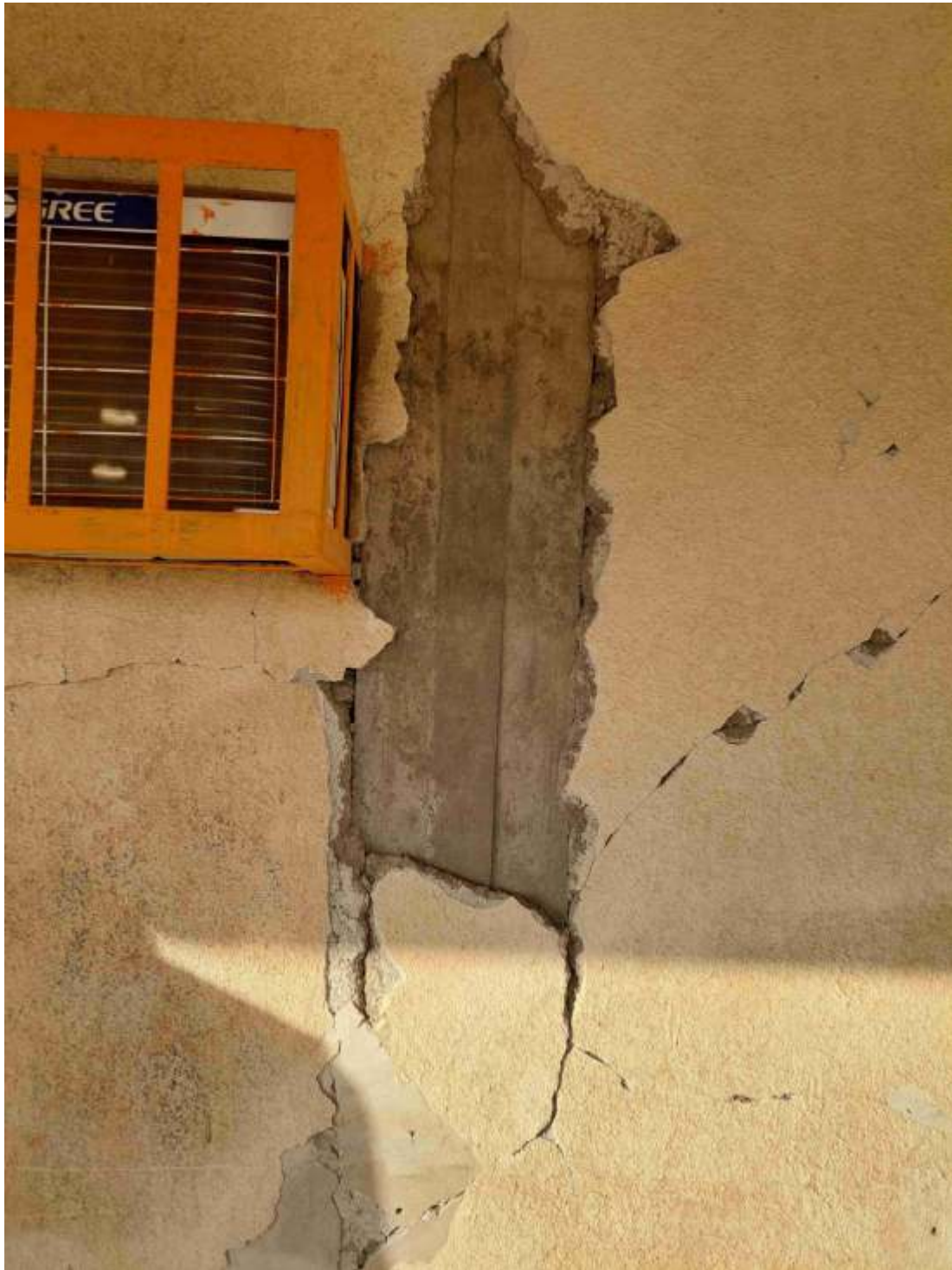
تصویر ۴۳ اجرای غیر اصولی دیوار میان قاب و جدا شدن و آسیب دیدن دیوار در اثر حرکت قاب (بخش فین)
