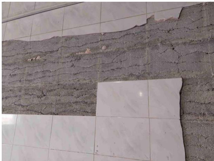
تصویر ۸۲ عدم اجرای صحیح زیرسازی سرامیک دیواری (بخش فین)
