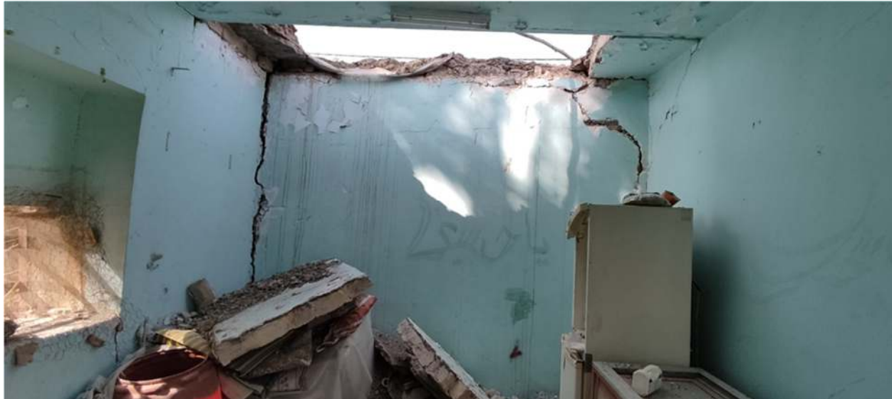
تصویر ۳۳ ریزش بخشی از سقف طاق ضربی به دلیل حرکت دیوار و عدم پیوستگی سقف با میلگردهای مهار
