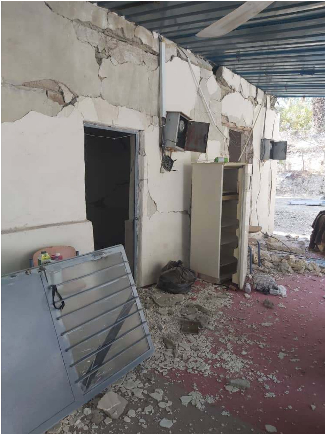
تصویر ۲۵ ترک‌های افقی دیوار بلوک سیمانی در روستای مزرا
