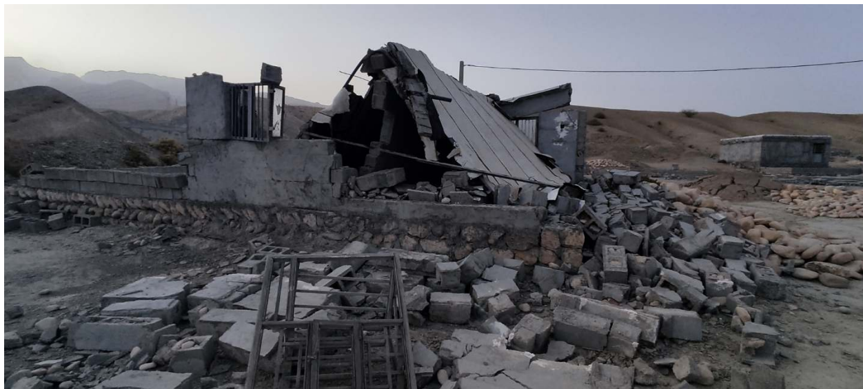
تصویر ۳۴ ریزش سقف (سپری و سرامیک) و دیوار بلوکی به دلیل عدم اجرای کلاف در روستای گیشان
