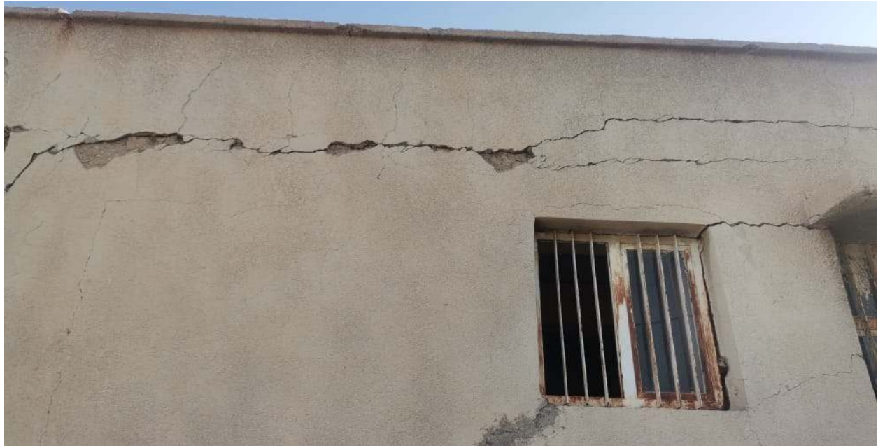
تصویر ۲۳ ایجاد ترک افقی در دیوار بلوک سیمانی روستای قطب آباد
