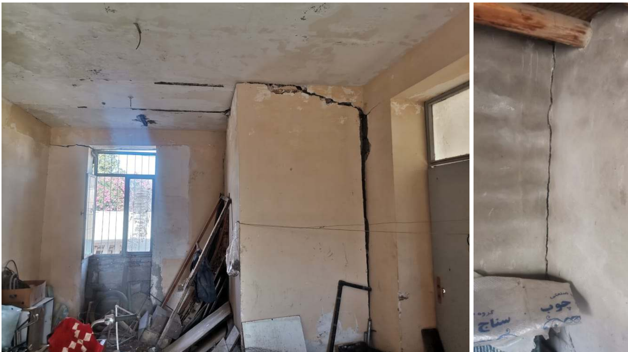
تصویر ۱۷ ایجاد ترک افقی و قائم در دیوارهای بلوک سیمانی روستای قطب‌آباد
