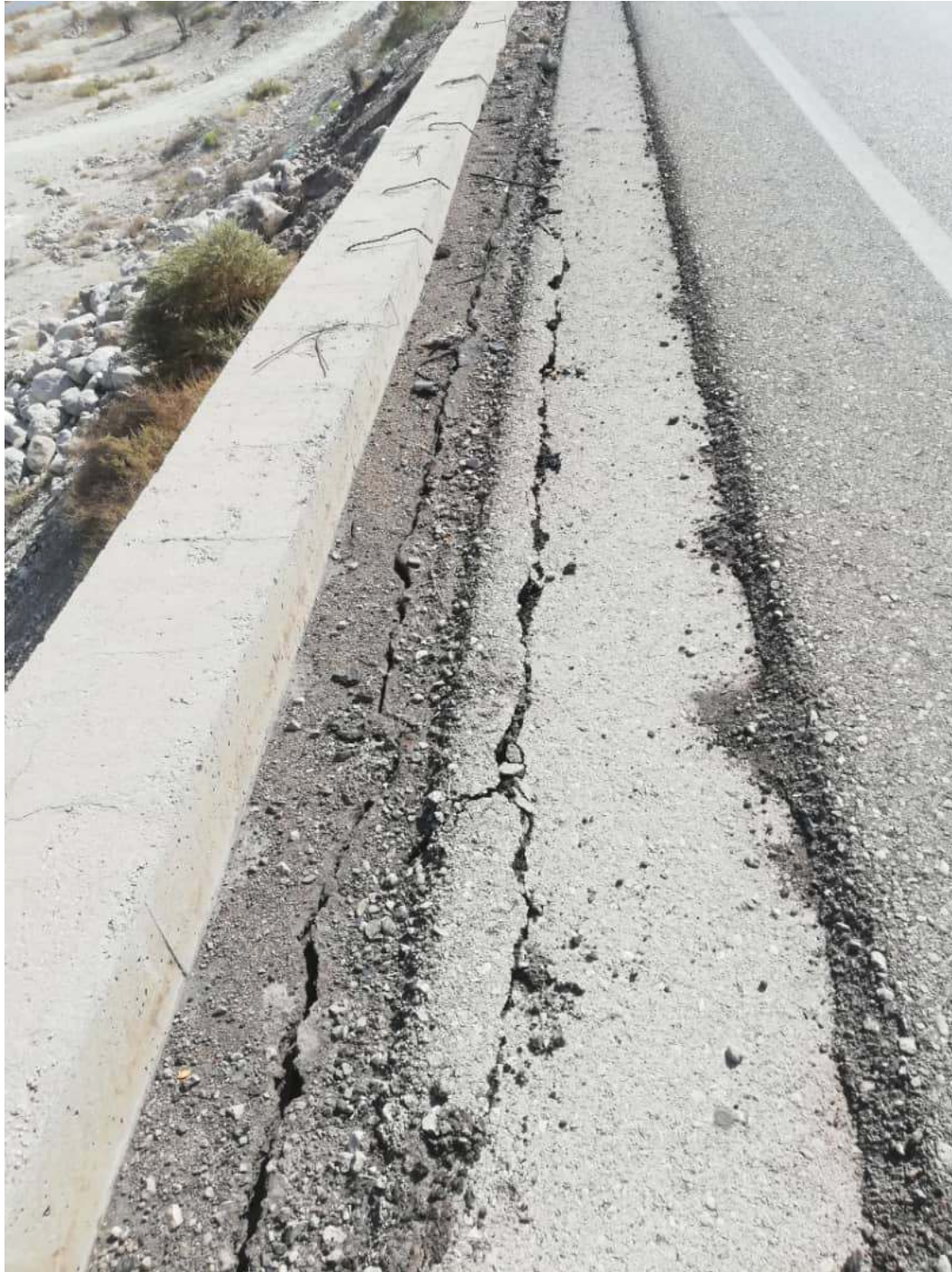
تصویر ۹۴ ترک طولی در محل اتصال پل و جاده
