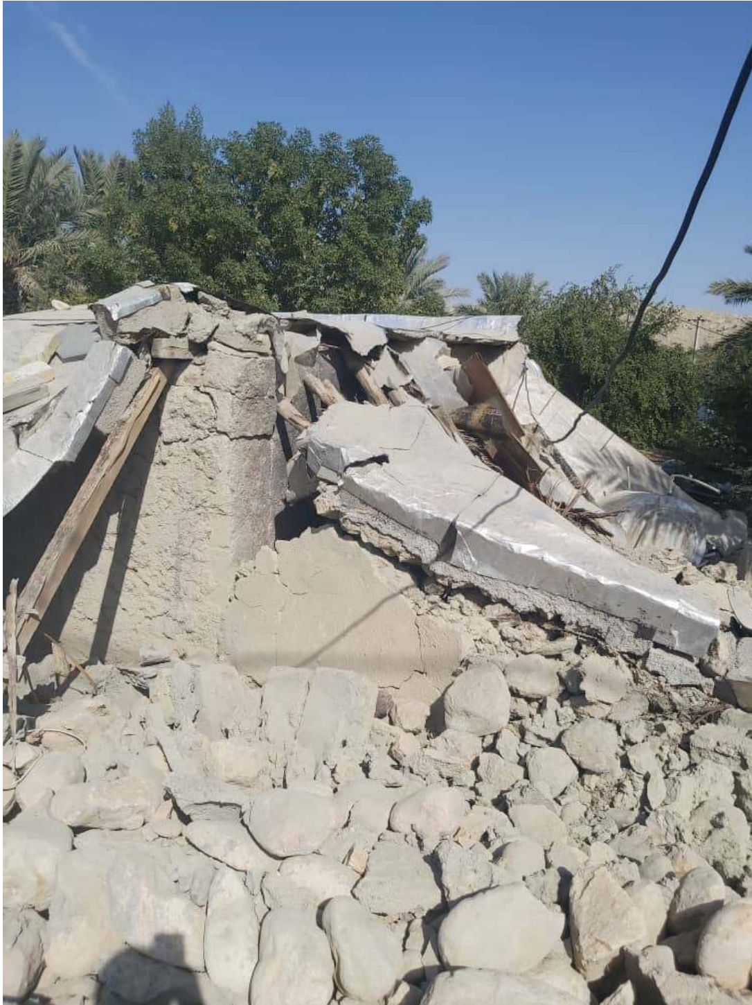
تصویر ۳۵ ریزش سقف با تیرک‌های چوبی و دیوارهای سنگی در روستای مژرا
