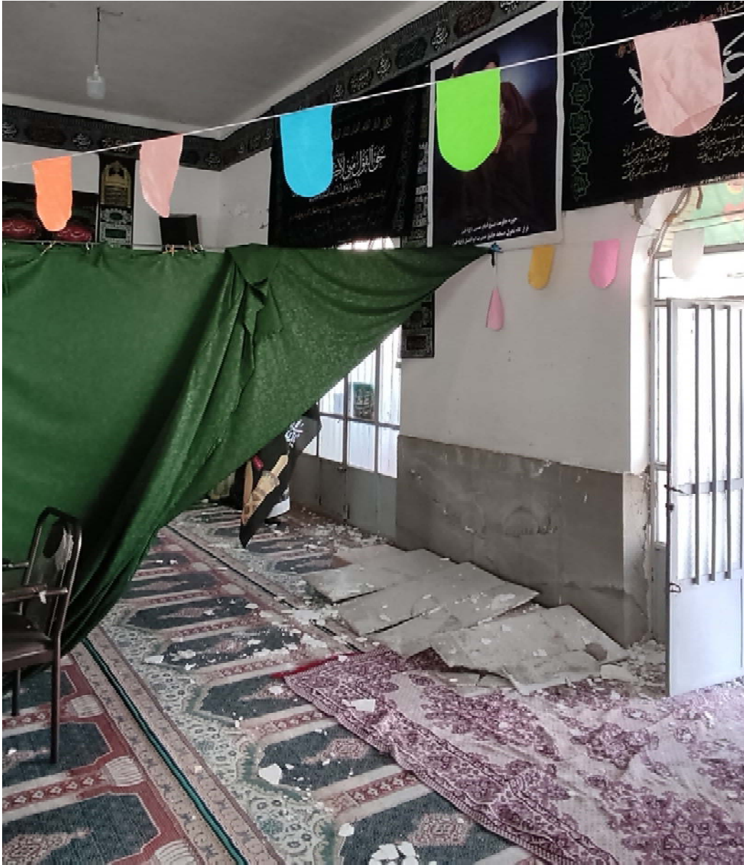
تصویر ۸۹ ریزش سنگ نمای داخلی به دلیل عدم رعایت اسکوپ مناسب در مسجد فین
