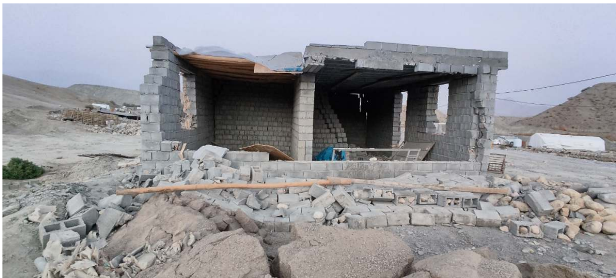
تصویر ۲۰ ریزش دیوار باربر ساختمان و بخشی از سقف به دلیل عدم اجرای کلاف و استفاده از ملات مناسب در گیشان غربی
