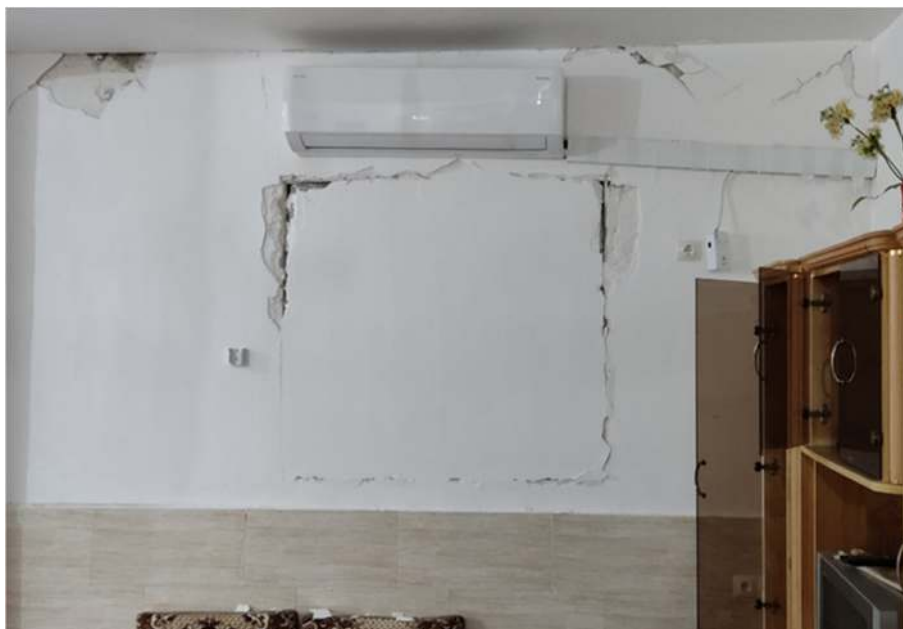
تصویر ۸۴ ایجاد ترک در دورتادور محل بازشو پنجره پوشانده شده با مصالح بنایی
