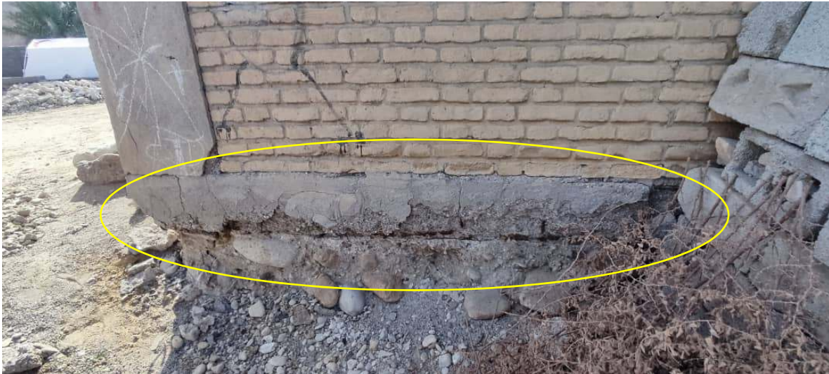
تصویر ۴۹ خوردگی کلاف و پای ستون سازه بتنی منبع آب در روستای سرزه
