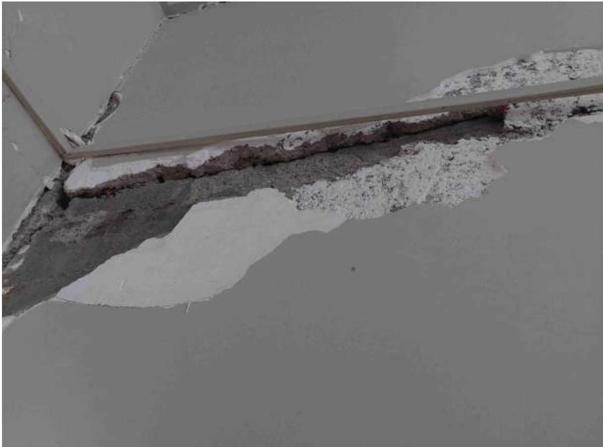
تصویر ۴۲ اجرای غیر اصولی دیوار غیر سازه‌ای بر روی تیر سازه‌ای و جدا شدن دیوار در هنگام زلزله (بخش فین)
