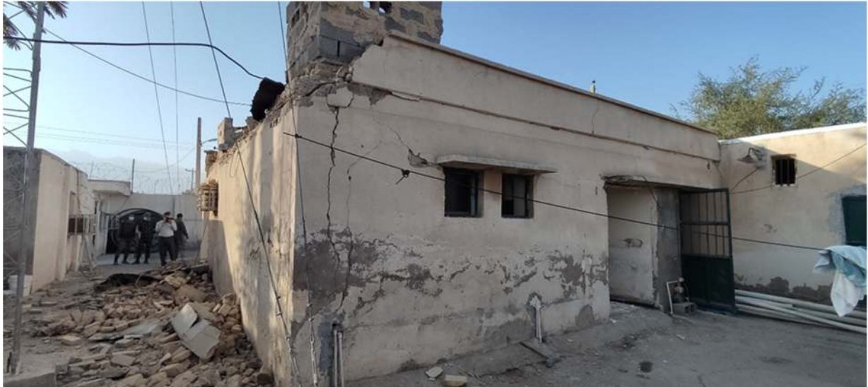
تصویر ۷۷ ترک خوردگی دیوار و ریزش جان‌پناه ساختمان پاسگاه روستای سرزه
