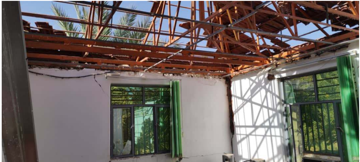
تصویر ۳۶ عدم اجرای صحیح سقف سفالی و ریزش آن در روستای ذرتو
